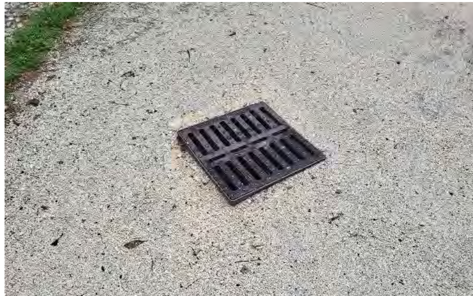
Accesso n. 7 ed esempio di caditoia inefficace
